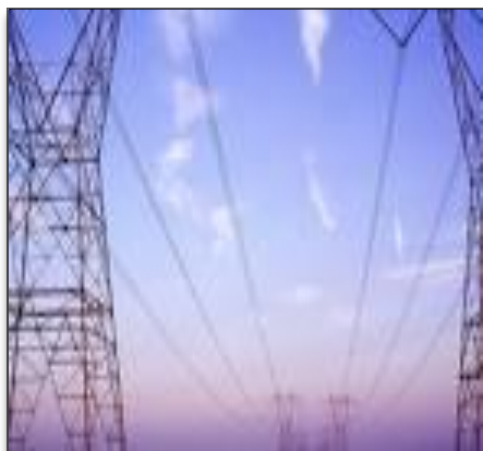
Energía (Transmisión Eléctrica)
